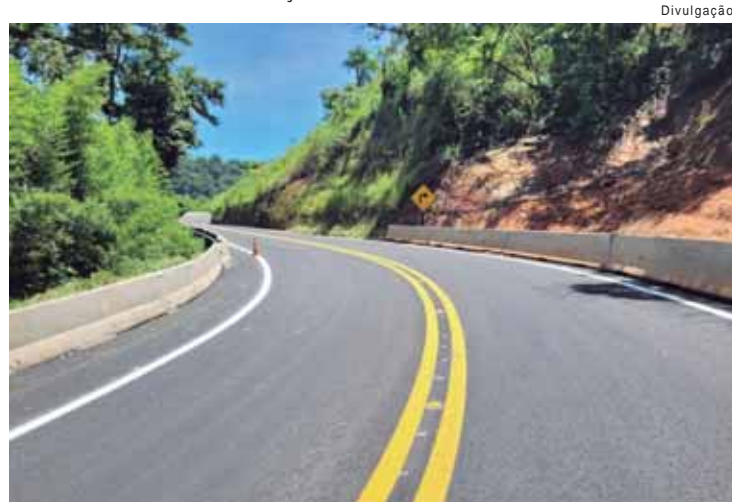
Trânsito entre Torrinhã e Santa Maria da Serra volta ao normal após conclusão dos trabalhos de reconstrução da via
