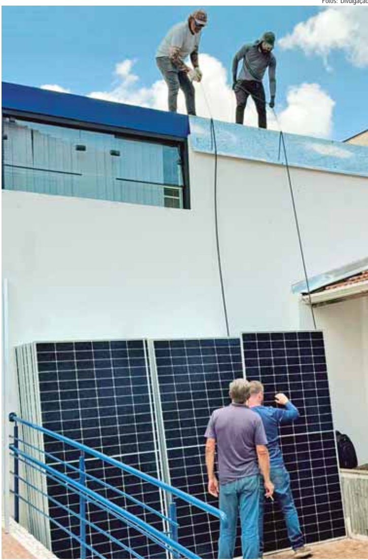
SindBan instalou painéis solares que devem gerar 2000 quilowatts de energia a cada mês
