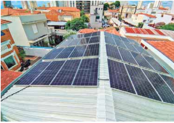
Painéis solares instalados no espaço de eventos do SindBan alimentará a sede e deve gerar excedente de energia
