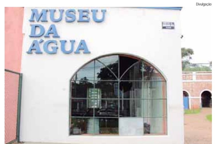
Vidros das janelas frontais do Museu da Água foram quebrados por vândalos
