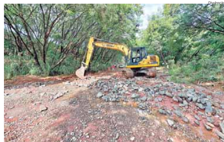
A Estrada PIR 009 foi comprometida por erosões
