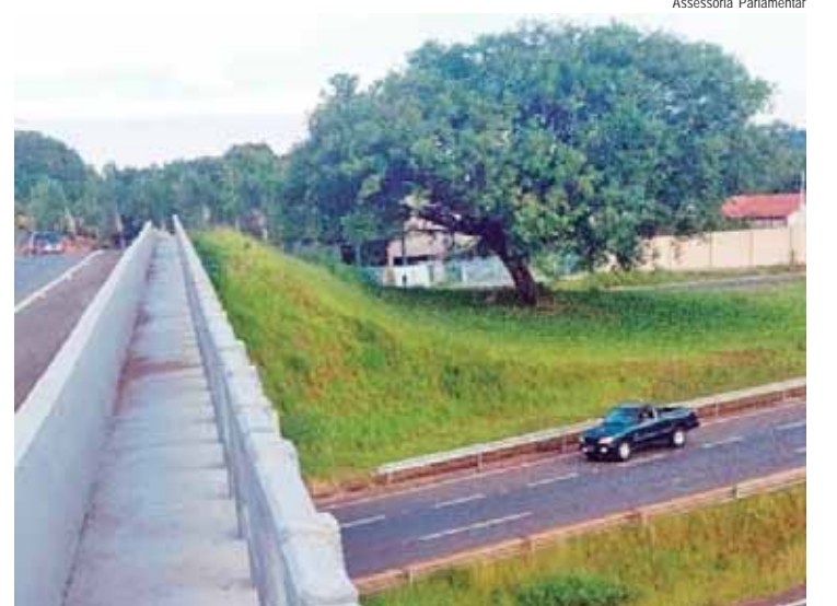
Pedido visa reforçar segurança no guarda-corpo para pedestres
