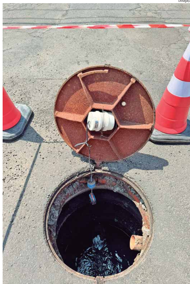
Medidores de nível são instalados nos PVs, identificando alteração nos níveis do esgoto
