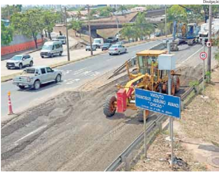
A equipe atua, no momento, com terraplenagem no trecho entre a passarela e a entrada do viaduto Chicão
