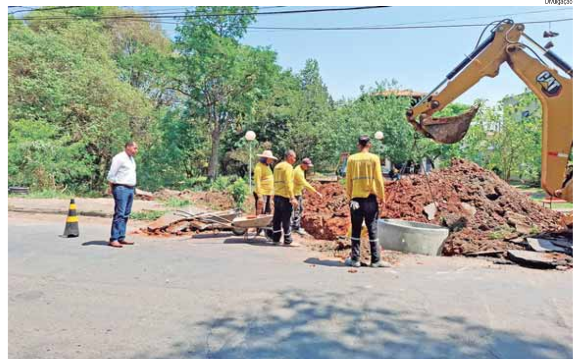
Thiago Ribeiro percorreu na manhã desta terça-feira (15) trechos da via para acompanhar o início de obras de pavimentação asfáltica, recuperação de ponte e sinalização
