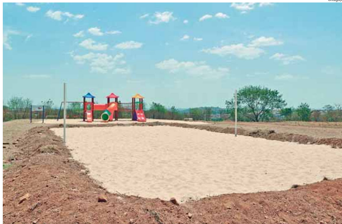
Foram instalados parquinho infantil, campo de futebol de areia e de vôlei de areia
