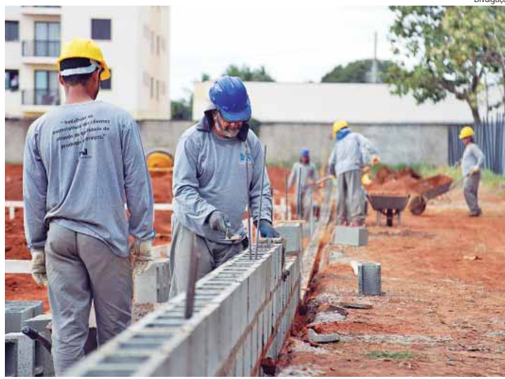
O prazo de execução da obra é de 12 meses e 11 funcionários da DWJ Engenharia estão trabalhando no local
