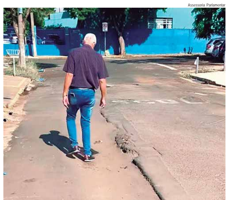
Sérgio da Van esteve no local com um engenheiro de águas pluviais da Secretaria Municipal de Obras e Zeladoria e cobrou providências do Executivo
