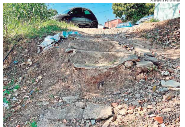
Em visita ao local, o vereador Paraná verificou a necessidade dessa melhoria, que está trazendo vários transtornos aos moradores
