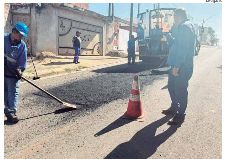
Vereador acompanhou na manhã desta terça (11) obras de melhorias viárias que também contemplam vias do bairro Parque das Águas
