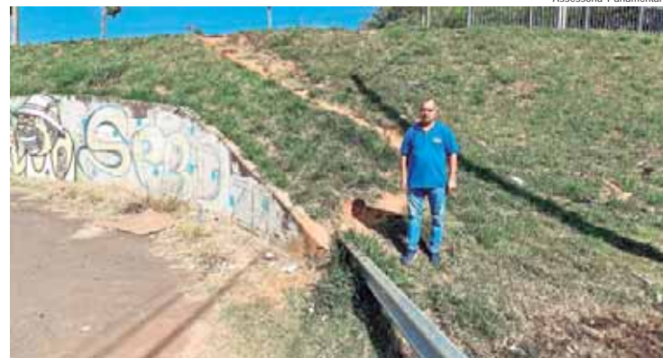
Em visita ao bairro, vereador Paraná verificou a necessidade da escadaria, cuja falta está causando transtornos aos moradores
