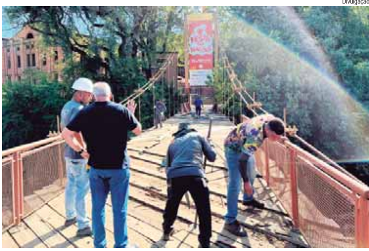
Rotta esteve no local quatro vezes antes de a reforma acontecer devido à preocupação com o estado de conservação da estrutura
