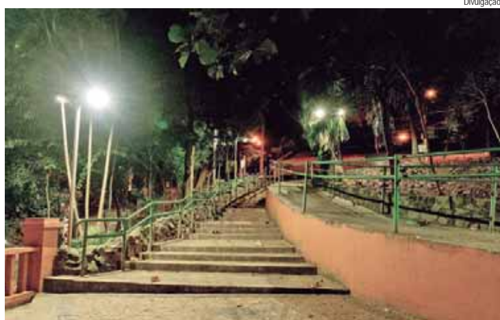
Foram executadas reposição de cabos que haviam sido furtados e fechamento de caixas de passagem
