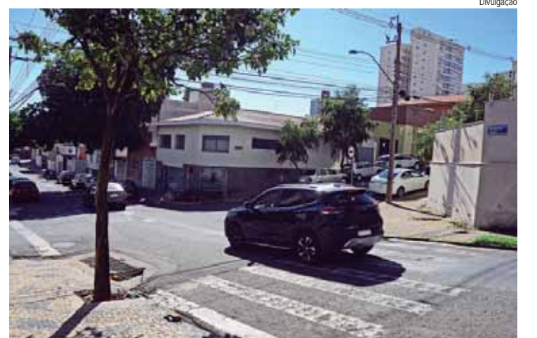
Serviço foi necessário durante obras para pavimentação da via em concreto, por conta do excesso de material bloqueando passagem da água
