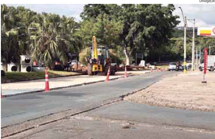
Serviço foi necessário durante obras para pavimentação da via em concreto, por conta do excesso de material bloqueando passagem da água
